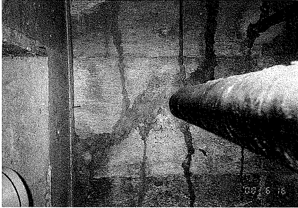
污水管，給水管を利用し蟻道をつくり地下室へ侵入
