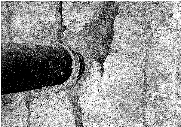
污水管を利用して外部からの侵入蟻道
