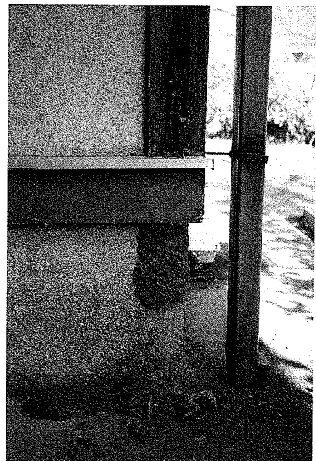
写真2 住宅内部は防除処理済みのため、外部基礎より侵入してきたイエシロアリの蟻道（熊本市）
