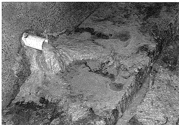
写真5 青函トンネル側壁の排水パイプ内とその周辺に発生した微生物のスライム
