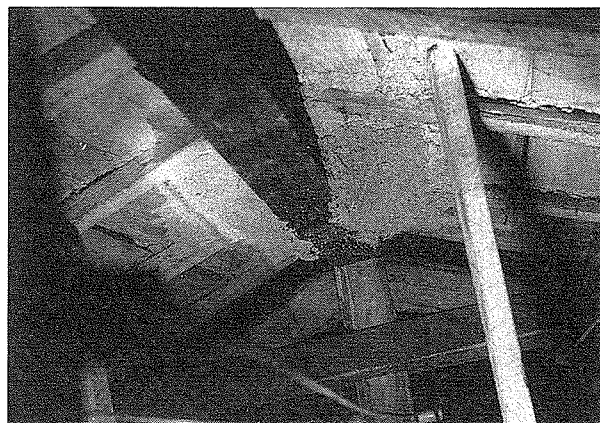
写真18 天井裏の棟木につくられたイエシロアリの巣
