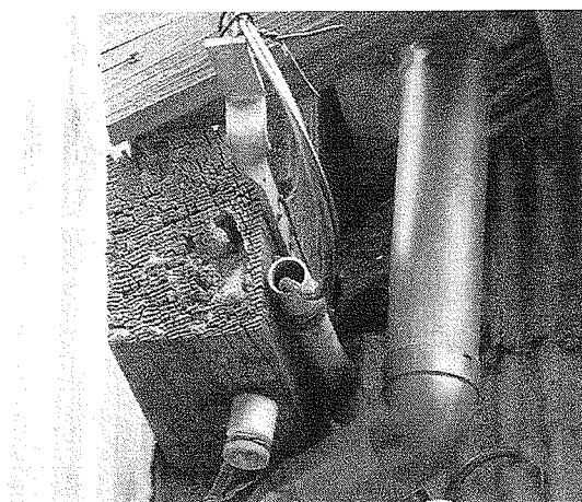
軒桁の蟻土有翅飛出し孔
