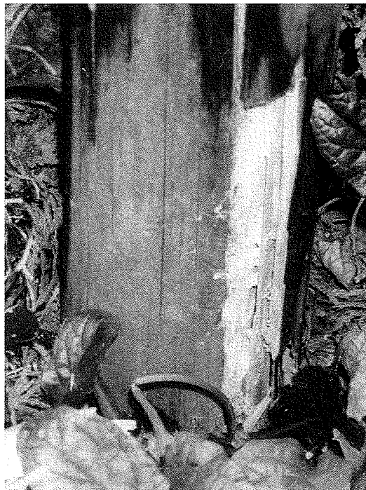
写真4 シロアリによる杭材の被害 (旭川市—平成13年)
