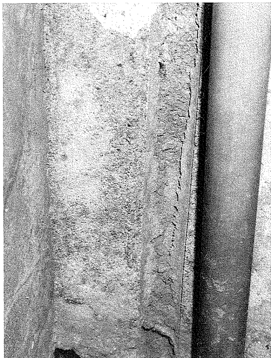
写真3 外壁側の基礎部分に築かれたシロアリ蟻道 (旭川市—平成13年)
