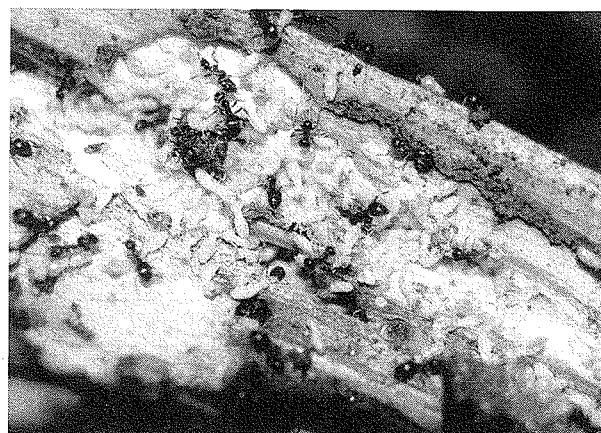
写真8 放置された端材における被害 (名寄市—平成13年)
