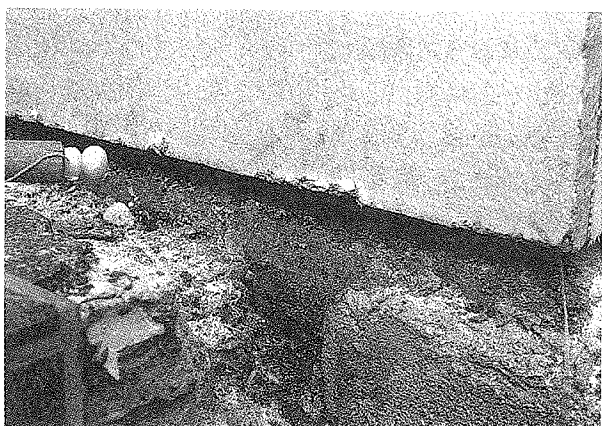
写真20 玄関タタキ取り付け部からの侵入
