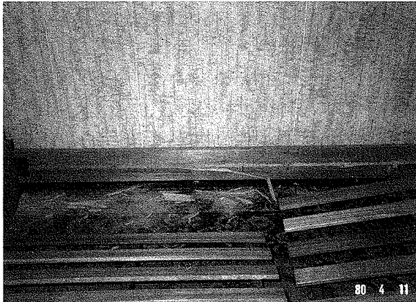
写真8 ヒラタキクイムシに食害されて床板が落ちたベッド
