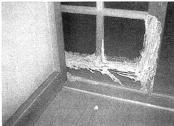
室内の被害状況
