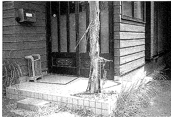
写真5 避難住宅の玄関柱の被害
