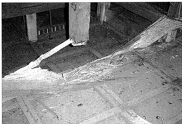
写真10 避難後に被害を受けた小屋梁
