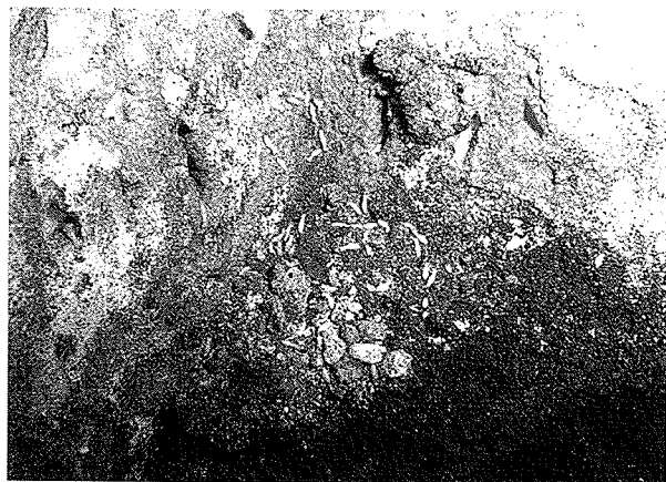
写真6 基礎（内壁）発泡断熱材を加害するシロアリ（事例3）
