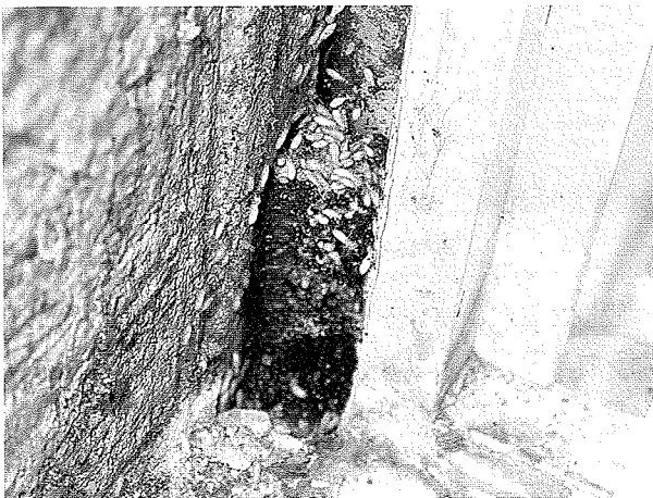
写真10 板壁隙間の状況
