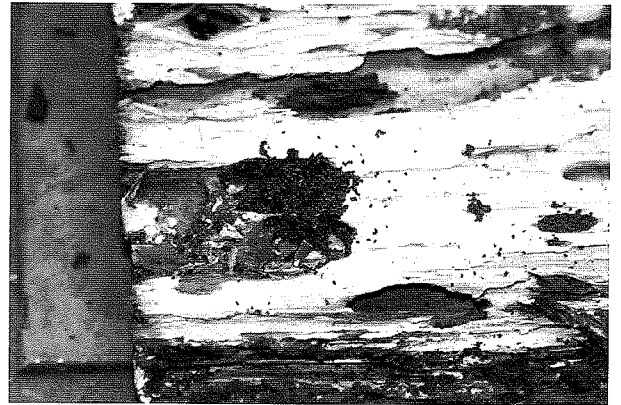
写真1 被害住宅の裏山に放置された丸太から発見されたアメリカカンザイシロアリの糞と食害痕
