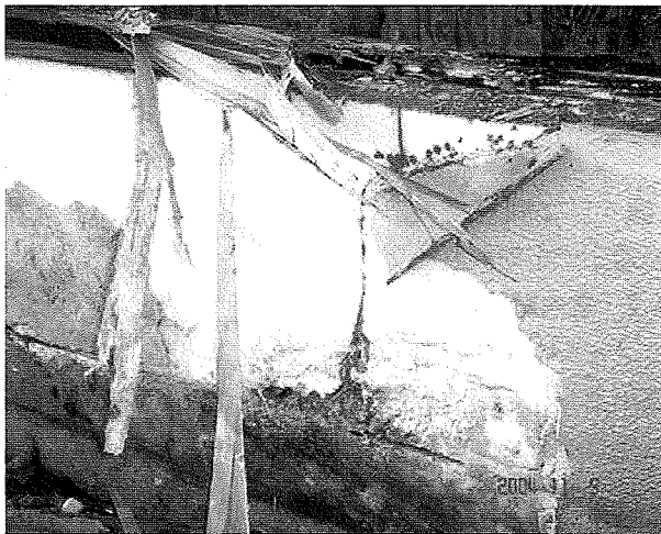
写真1 基礎外断熱住宅における蟻害調査の実例（解体中）
