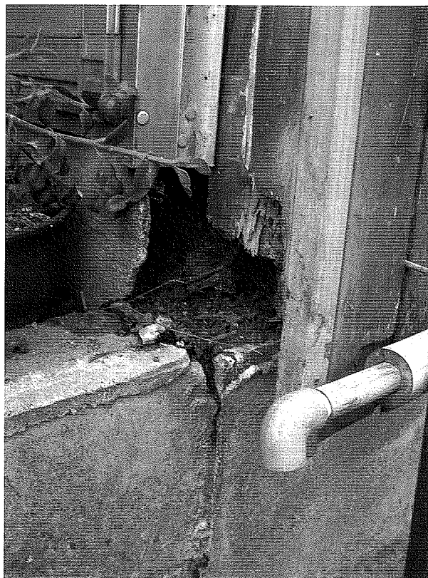
写真8 土台、柱に見られたシロアリによる被害(穴水町)
