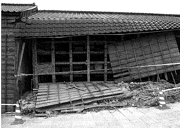
写真7 土蔵の被害 (北前船資料館・旧門前町黒島地区)
