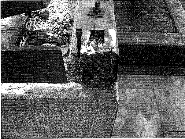
写真10 土台の腐朽による被害 (旧門前町道下地区)
