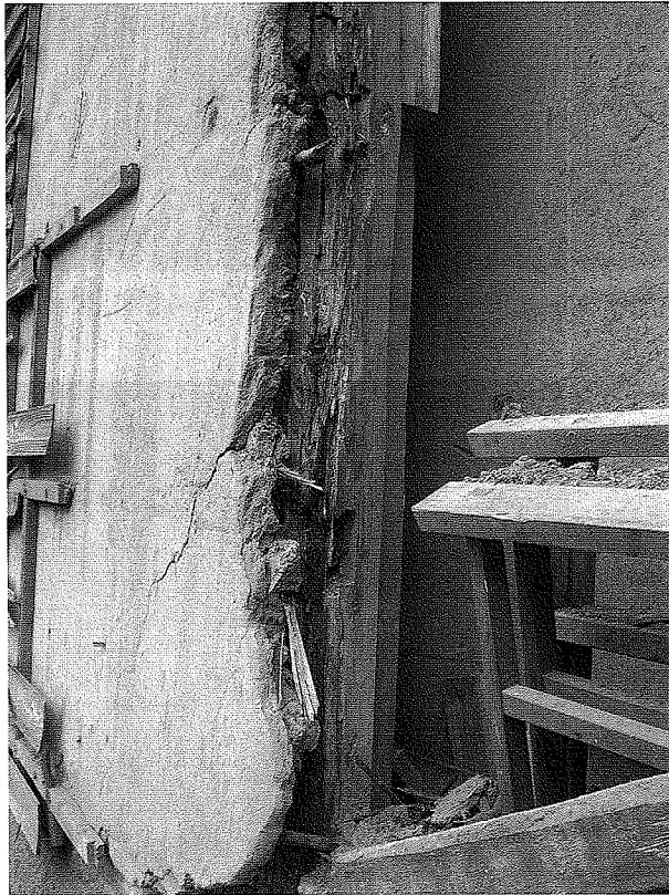
写真11 土壁内の枠材の腐朽 (旧門前町黒島地区)
