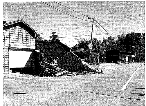
写真29 倒壊している住宅
