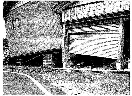
写真11 完全に1階が崩壊した住宅と比較的新しい倉庫
