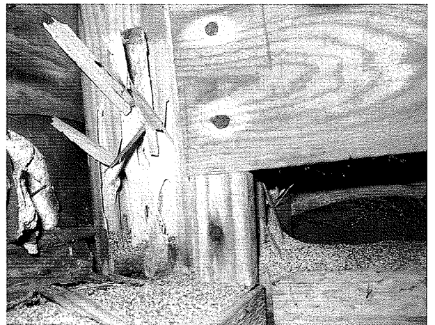
写真3 若宮地区での被害写真
