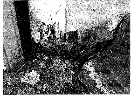
写真19 商店街に面した正面の柱の蟻害
