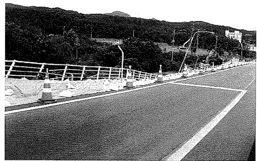
写真4 道路脇が崩れている様子
