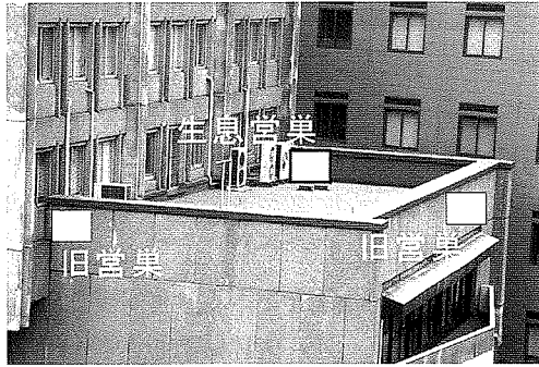
写真10 3階屋上イエシロアリ営巣位置
