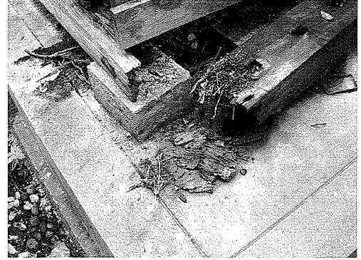
写真8 建物の土台の腐れ
