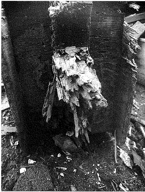
写真3 ほぞ部分が食害によりなくなってしまった梁
