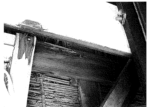
写真21 食害の大きい柱と梁
