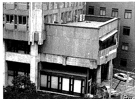
写真2 建物被害部2・3階外観
