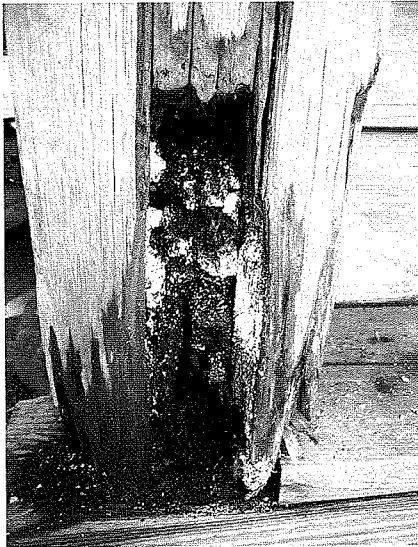
写真16 土台付近の腐朽
