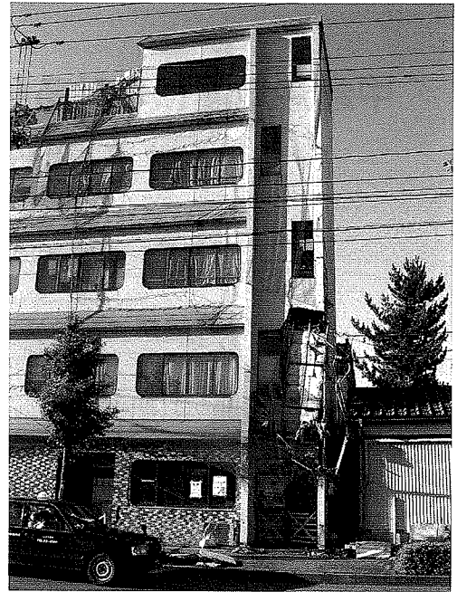
写真2 鉄骨造の建物の被害例（柏崎市内）
