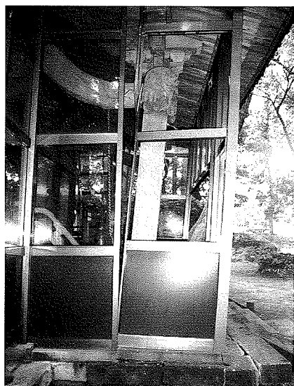
写真12 正面側に傾いている拝殿
