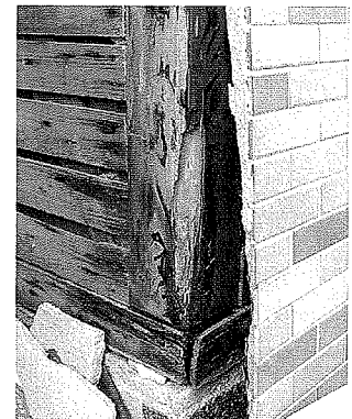
写真18 外壁の崩落, 腐朽
