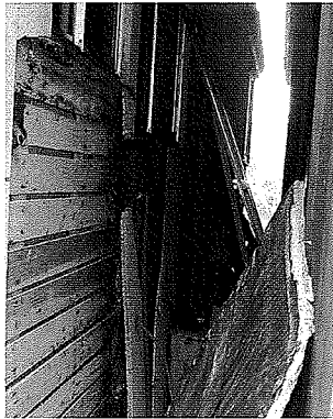
写真16 外壁の崩落, 腐朽
