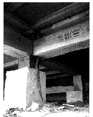
写真32 独立基礎の蟻道
