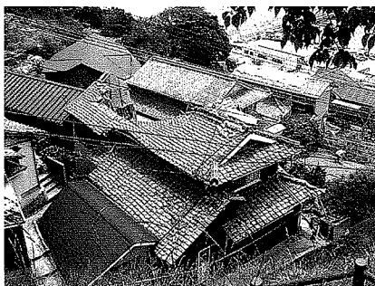
写真38 崩落した屋根
