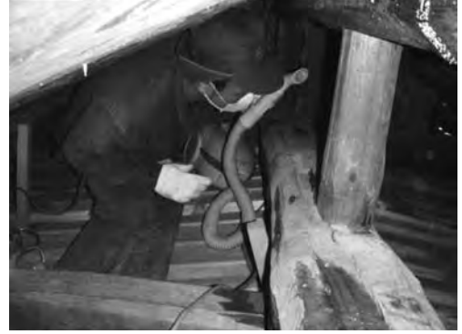
写真19 母屋 天井裏① (目視法による効力判定が行えるよう 虫糞を丁寧に除去した)
