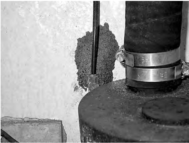
写真4 船尾配管部蟻土
