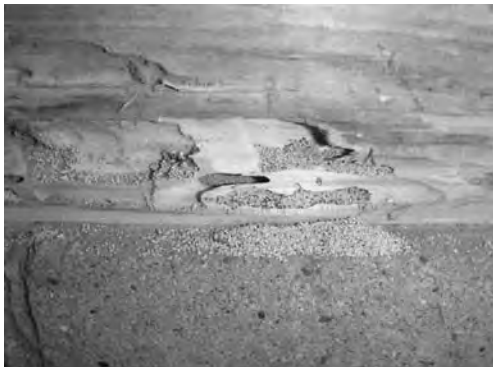
写真3 倉庫 土台② (拡大)
