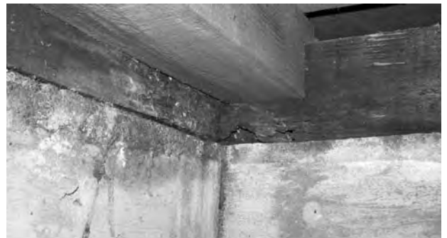
写真3 カンモンシロアリの被害箇所（12月下旬）
