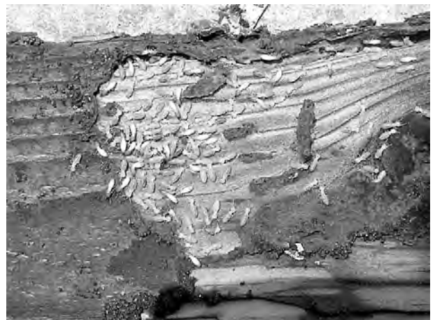
写真7 小屋壁板のシロアリ被害
