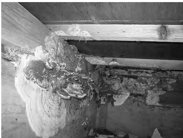
写真6 和室の基礎の子実体
