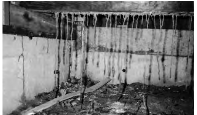
写真7 平成19年11月空中蟻道
