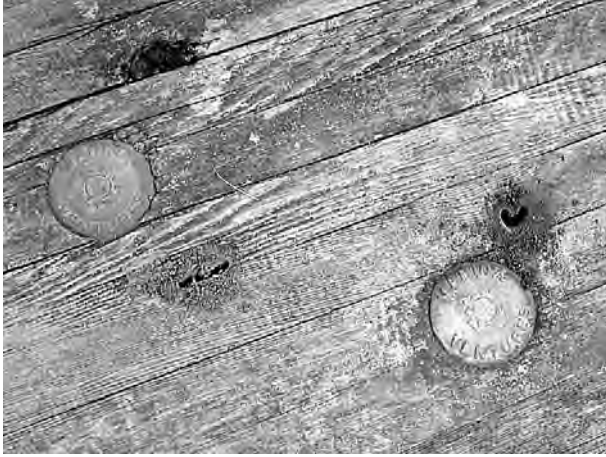
写真9 浮き棧橋デッキのシロアリ被害
