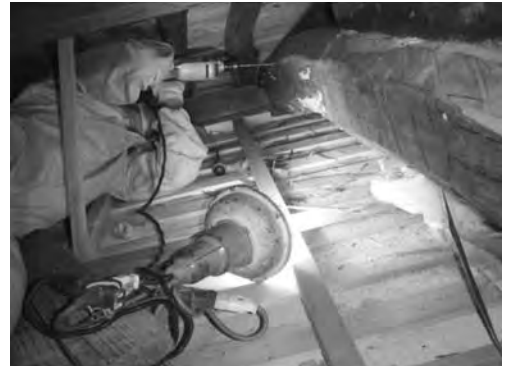
写真20 母屋 天井裏② (穿孔)
