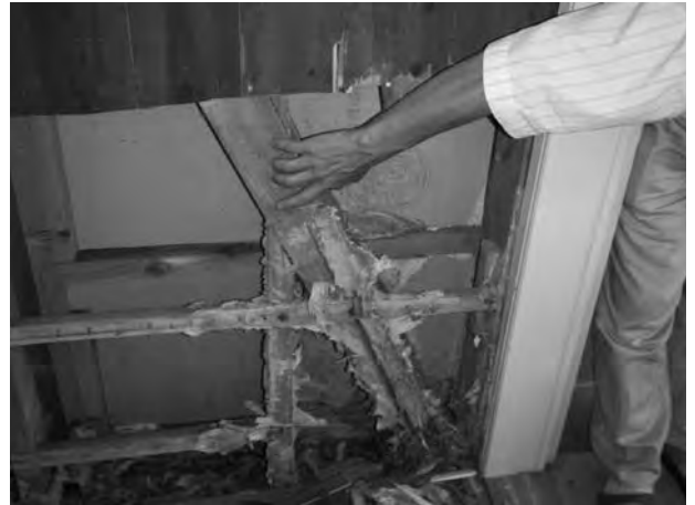
写真12 壁内のすじかいの被害
