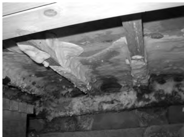
写真5 ホール床板の陥没した穴
