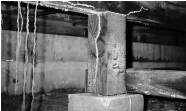
写真6 平成19年11月空中蟻道
