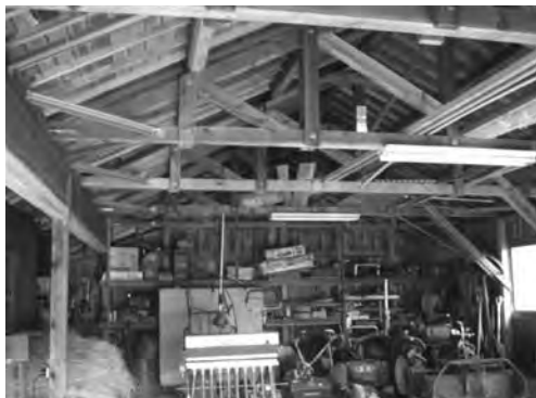
写真23 倉庫（建物全面に被害箇所があった）
