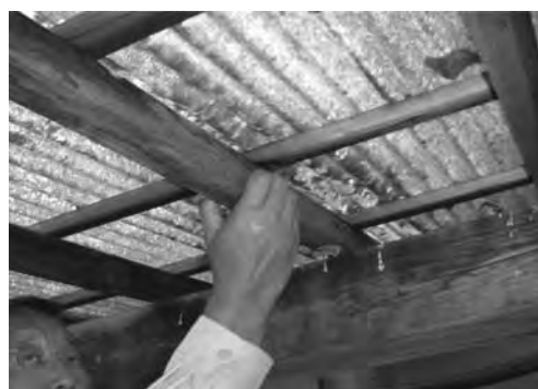
写真28 施工漏れ箇所（垂木の1本に大きな食害があった。なお，この場所の他の部材に被害箇所は確認されなかった）
