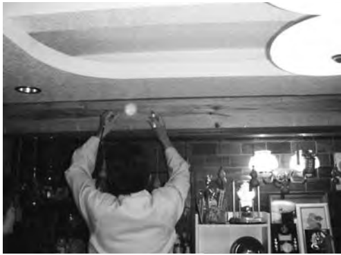
写真9 母屋 応接間① (被害箇所を把握しやすいよう、虫孔があった箇所にマジックで印をつけた。壁紙ははがしてある)
