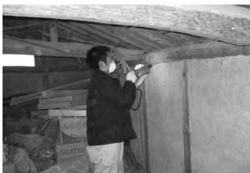
写真24 倉庫2F①（穿孔）
