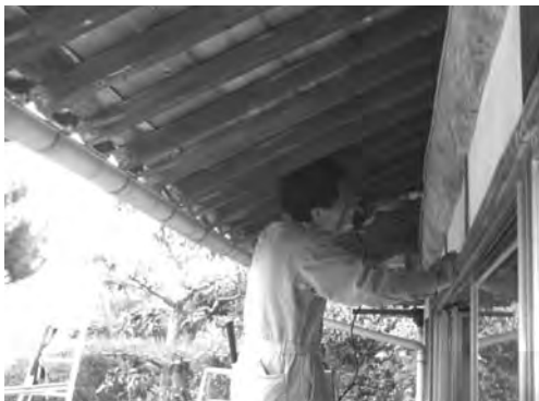
写真18 母屋 縁側外 (穿孔)
