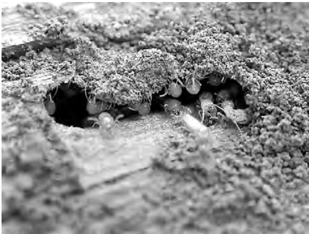
写真10 デッキのシロアリ被害拡大
