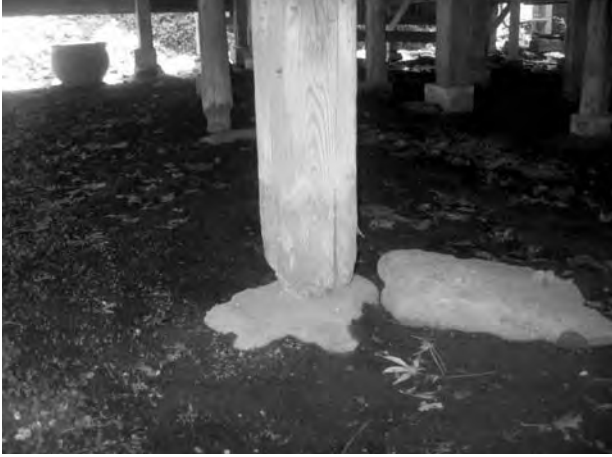
写真5 東下部の腐朽（妙法華寺奥書院）
