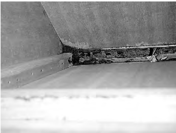
写真5 ロッカー底栈木シロアリ被害
