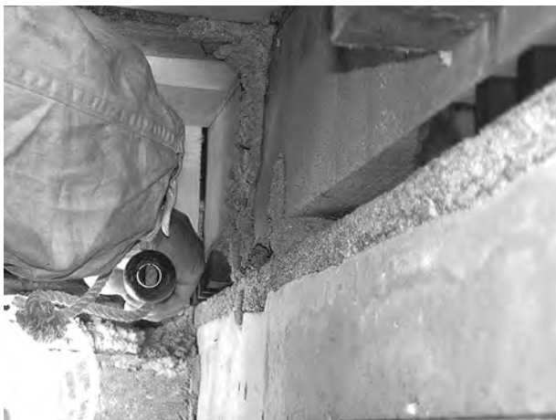
写真5 ねこ土台被害写真02-1 ねこ土台蟻道
