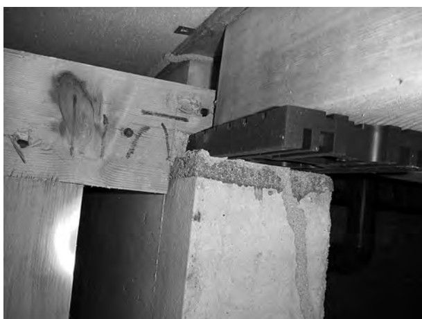
写真11 ねこ土台被害写真03-4 ねこ土台蟻道
