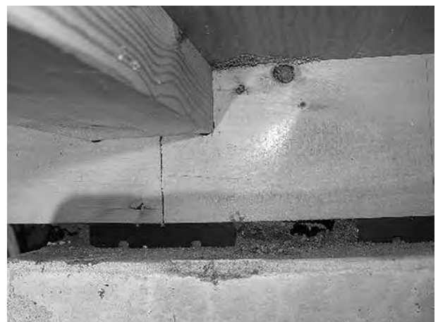
写真2 ねこ土台被害写真01-2 ねこ土台蟻土
