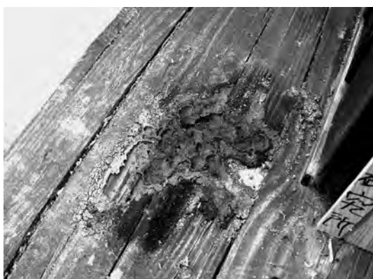
写真3 橋床板袖部の蟻土
