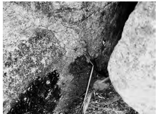
写真10 東側橋脚の蟻道
