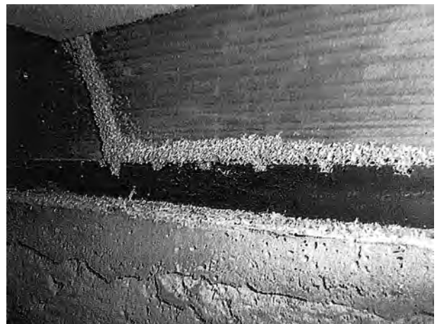
写真20 ねこ土台被害写真05-4 ねこ土台蟻道
