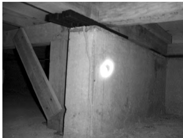
写真12 ねこ土台被害写真03-4 ねこ土台蟻道
