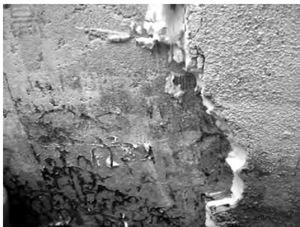
写真26 基礎外断熱材被害写真07-2 外断熱材被害
