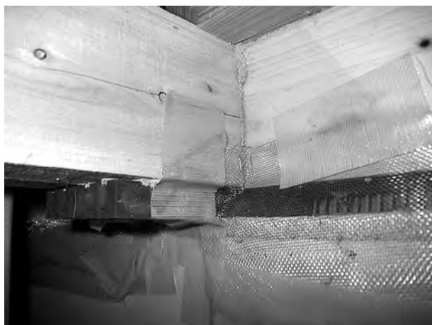
写真21 ねこ土台被害写真06-1 ねこ土台蟻道
