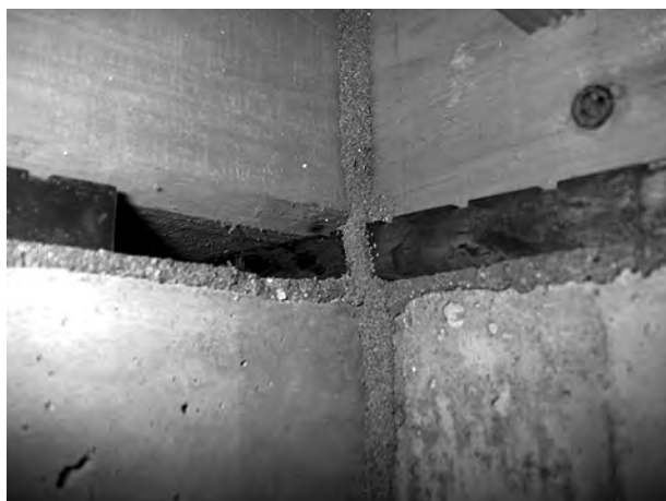
写真23 ねこ土台被害写真06-3 ねこ土台蟻道
