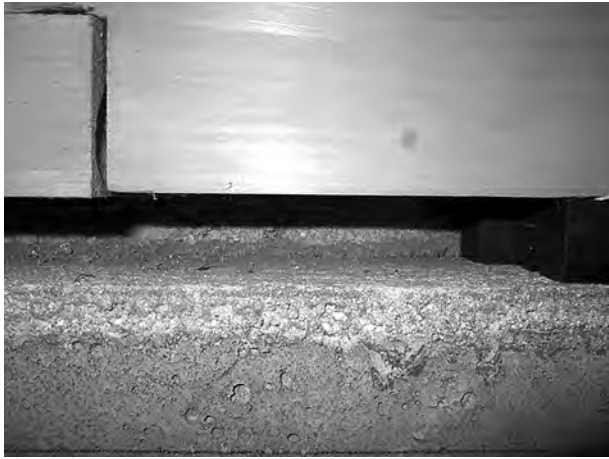
写真15 ねこ土台被害写真04-3 ねこ土台蟻道
