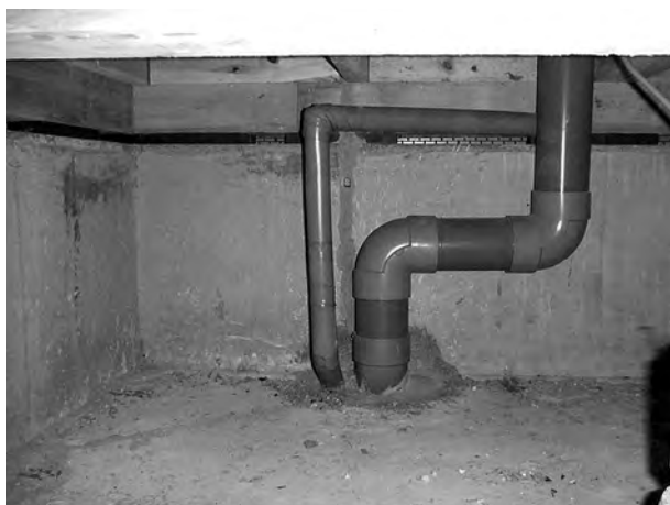
写真9 ねこ土台被害写真03-1 床下蟻道
