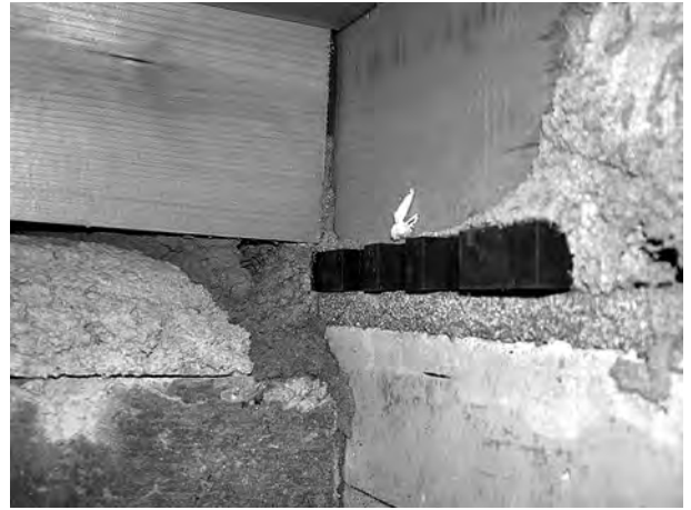
写真6 ねこ土台被害写真02-2 ねこ土台蟻道
