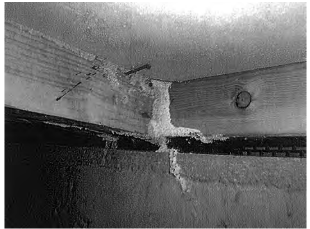
写真19 ねこ土台被害写真05-3 ねこ土台蟻道
