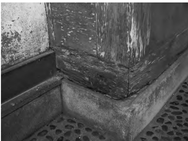
写真11 土台の腐朽およびシロアリの食害あと
