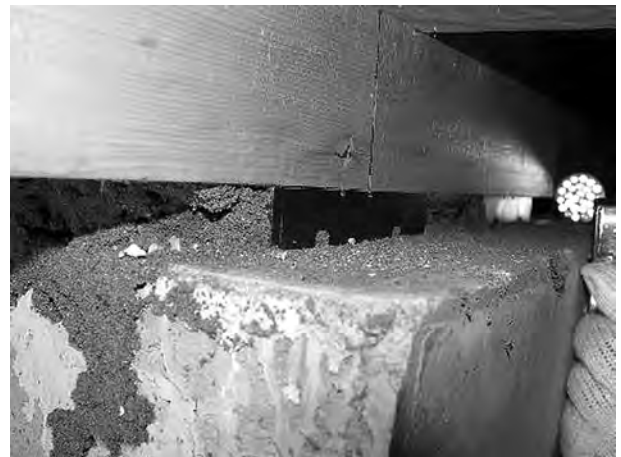
写真1 ねこ土台被害写真01-1 ねこ土台蟻道
