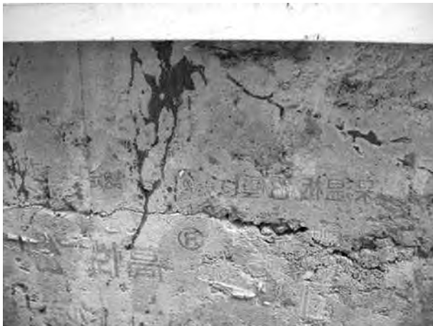
写真28 基礎外断熱材被害写真07-4 外断熱材被害
