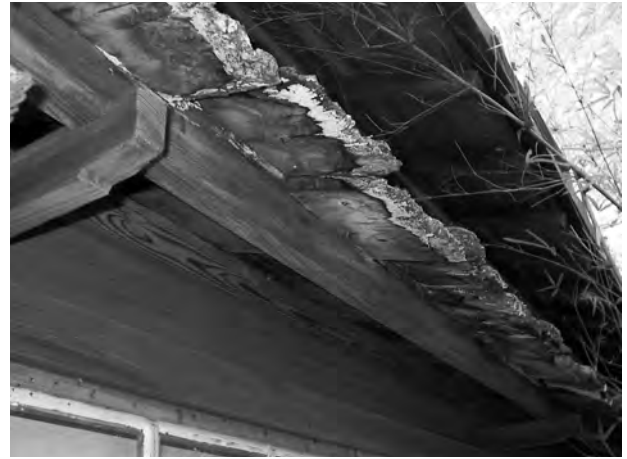
写真12 霧除けの腐朽
