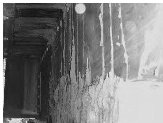
写真5 西側橋脚部内側蟻道
