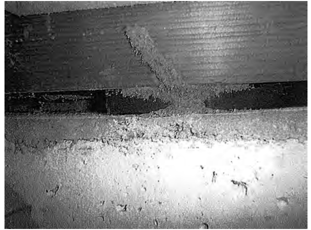
写真18 ねこ土台被害写真05-2 ねこ土台蟻道
