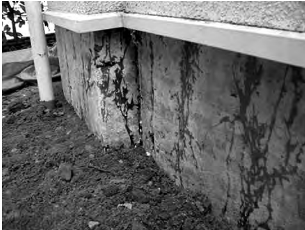
写真27 基礎外断熱材被害写真07-3 外断熱材被害
