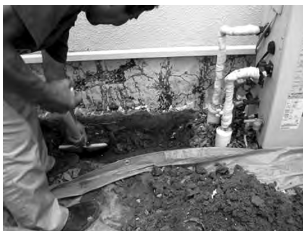
写真25 基礎外断熱材被害写真07-1 外断熱材被害
