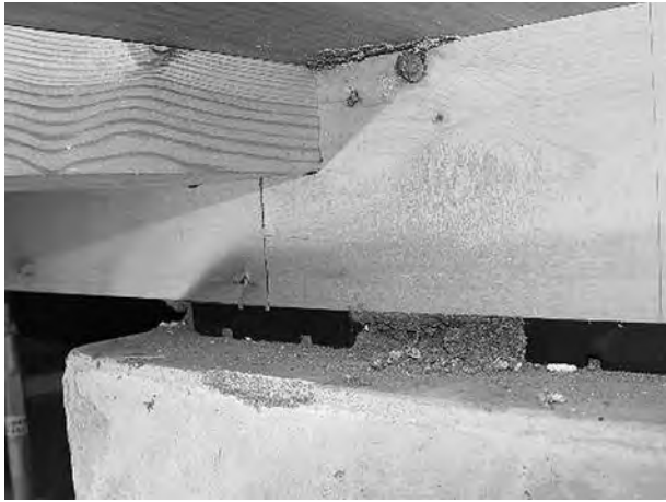
写真3 ねこ土台被害写真01-3 ねこ土台蟻土
