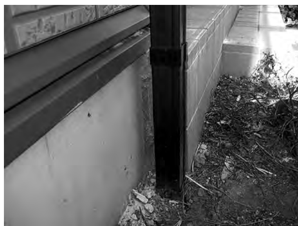
写真13 ねこ土台被害写真04-1 外蟻道
