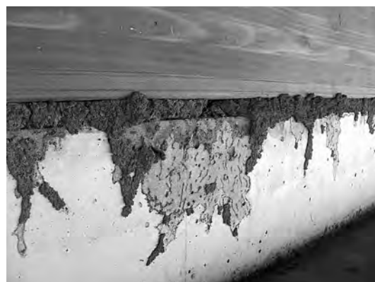
写真4 西側橋脚部蟻土
