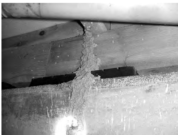
写真10 ねこ土台被害写真03-2 ねこ土台蟻道
