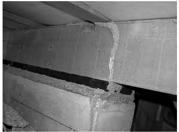
写真7 ねこ土台被害写真02-3 ねこ土台蟻道
