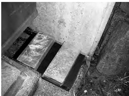
写真12 ベイトボックス設置状況
