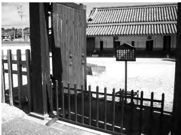
写真3 関所入口の門および木製の柵 イエシロアリの被害あり現在被害進行中
