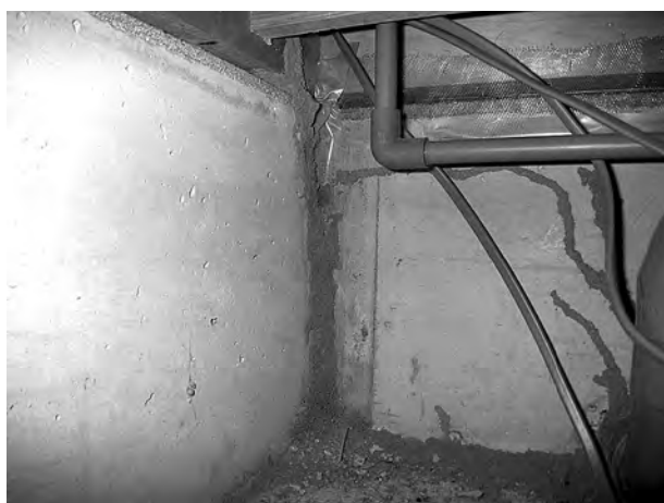
写真22 ねこ土台被害写真06-2 床下蟻道
