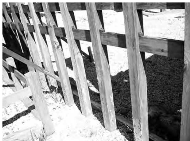
写真5 門に隣接した木製の柵のイエシロアリの被害
