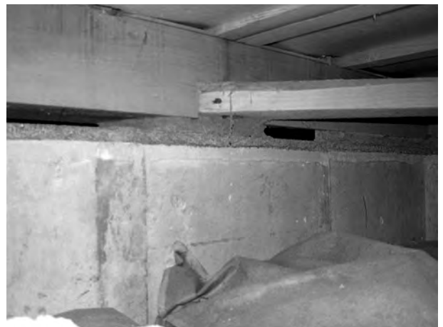
写真8 ねこ土台被害写真02-4 ねこ土台蟻土
