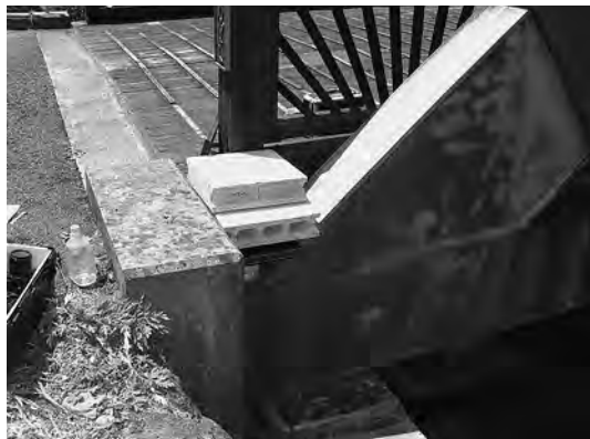
写真7 ベイトボックス設置状況
