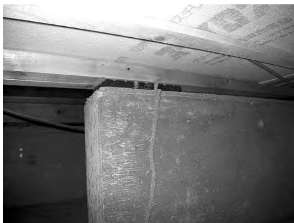
写真24 ねこ土台被害写真06-4 ねこ土台蟻道
