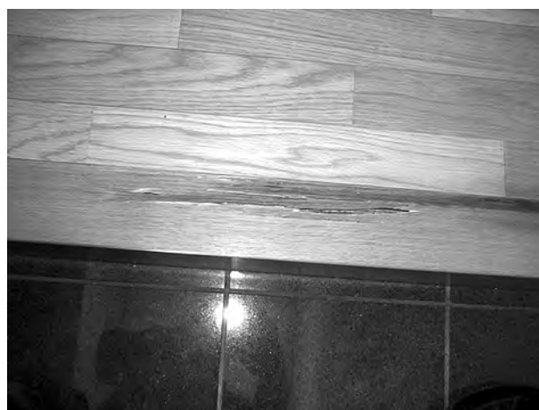
写真14 ねこ土台被害写真04-2 玄関框被害
