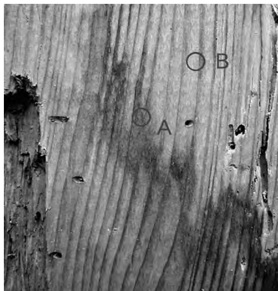
写真5 診断具を適用した実際に腐朽している木材 A：変色しており腐朽が疑われる部分 B：健全と思われる部分
