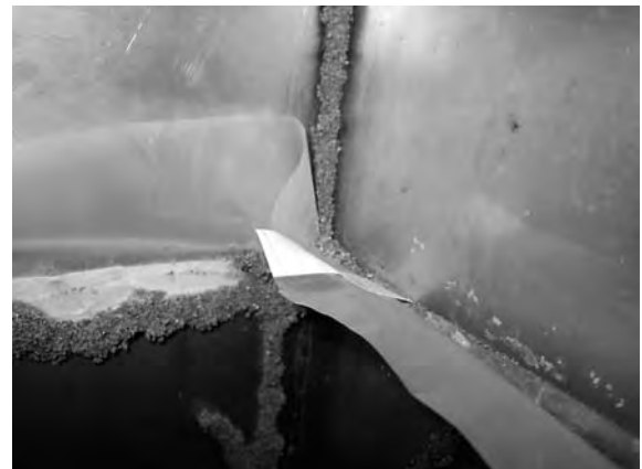
図3 入り隅接着層からの蟻道侵入の様子
