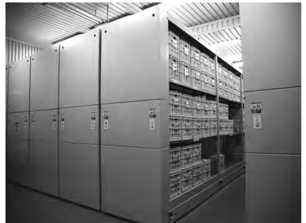
写真4 es-BANKの冷凍室(約400㎡, -25℃)
