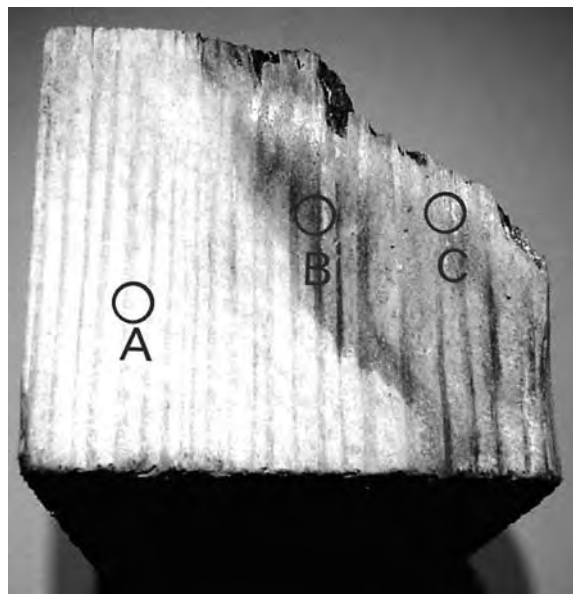
写真6 診断具を適用した実際に腐朽している木材 A：健全と思われる部分 B、C：変色しており腐朽が疑われる部分
