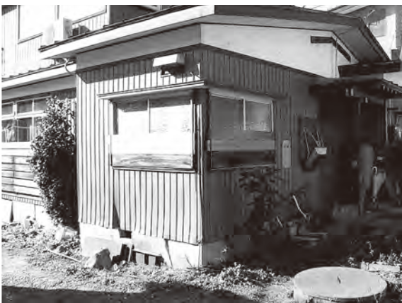
写真6 基礎の破断で危険と判定された住宅
