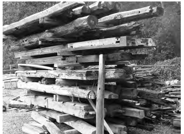
写真12 ブロッカー9 廃棄材 梁, 桁, 大引, 鴨居(松) 関係 クロタマムシ, シバンムシ, ヤマトシロアリ, 腐朽の複 合被害。(大)
