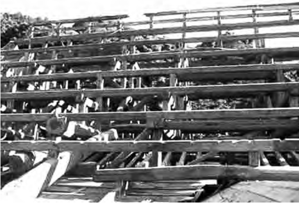
写真8 本堂小屋組 (松)(杉)(桧) 棟木雨漏れによる腐朽, ヤマトシロアリの複合被害。(大) (棟の造りが瓦と土の場合蟻害が多い)
