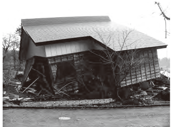
写真8 層崩壊した元茅葺屋根老朽建物
