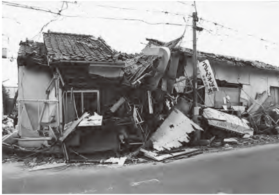
写真3 1階が店舗部分に壁がほとんどない
