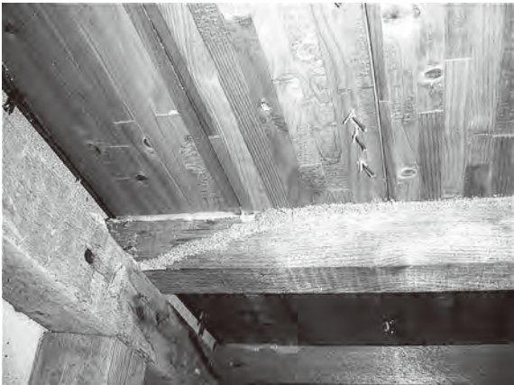
写真11 細い柔らかい蟻道，構造材に被害なし
