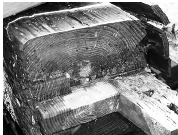
写真18 大引（松） 接合部 クロタマムシ、シバンムシ、ヤマトシロアリの複合被害。(大)
