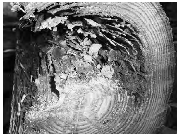
写真19 大引（松） クロタマムシ、ヤマトシロアリ、腐朽の複合被害。(大)
