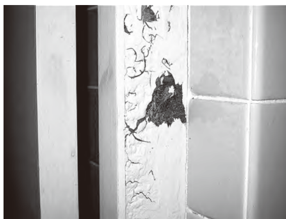
写真10 鉄筋2階トイレに木被害
