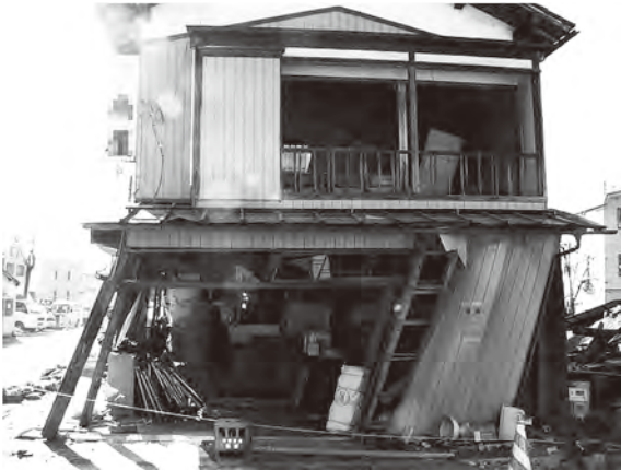
写真5 大傾斜で危険と判定された店舗住宅
