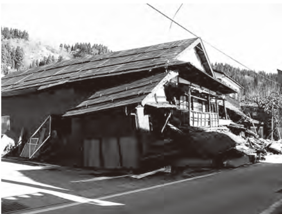
写真7 1階が層崩壊した土壁の古い住宅
