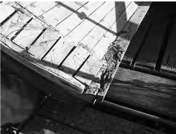
写真9 屋根鼻棧付近のヤマトシロアリ被害 他にも野地板被害あり。(大)
