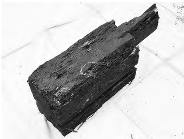
写真15 大引（松） 接合部 クロタマムシ、シバンムシの複合被害。(大)
