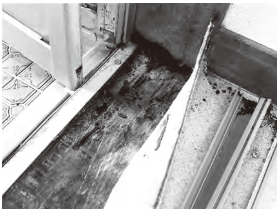
写真19 脱衣場のシロアリ被害
