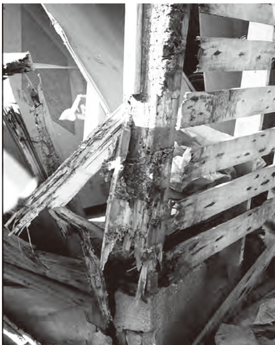
写真4 蟻害による隅柱注脚部の欠損
