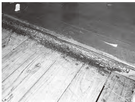
写真8 畳を食害し、床板の被害がない事例
