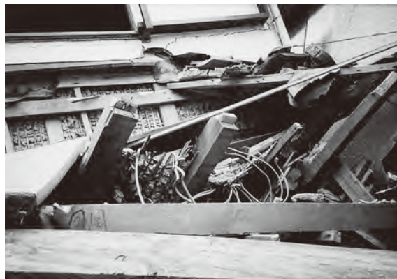
写真1 補強金物のない短いはごの柱頭部
