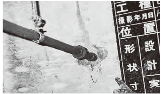
写真5 配管周りからのイエシロアリの蟻道
