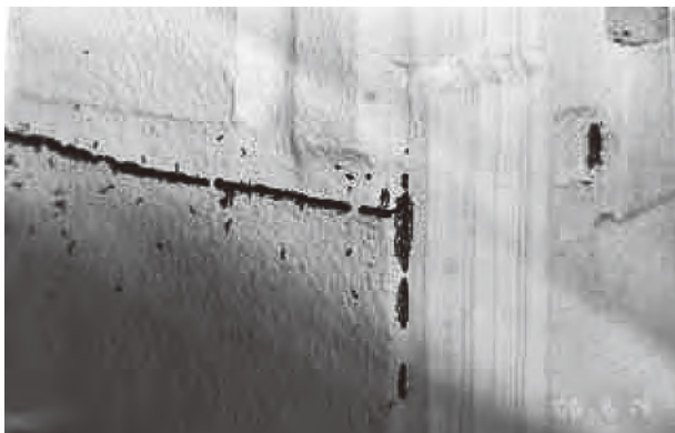
写真8 イエシロアリのコーキングの食害状況
