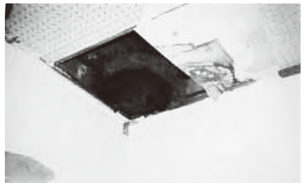
写真10 天井のイエシロアリの食害状況
