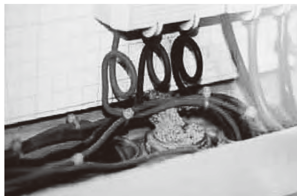
写真15 電気ケーブルに出来たイエシロアリの巣
