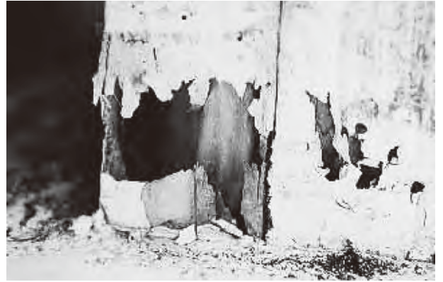
写真25 ダイコクシロアリの被害
