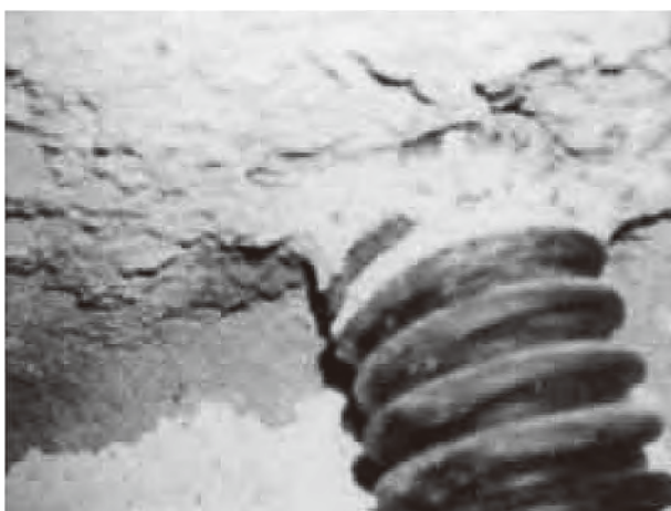
写真14 蟻土で覆われた電気ケーブル
