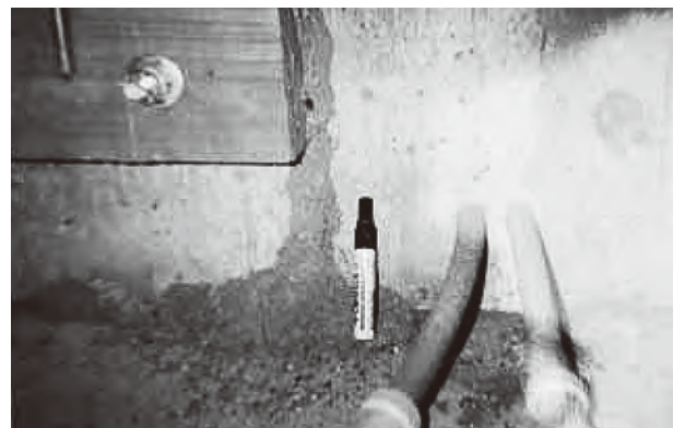
写真6 床下にできたイエシロアリの蟻道
