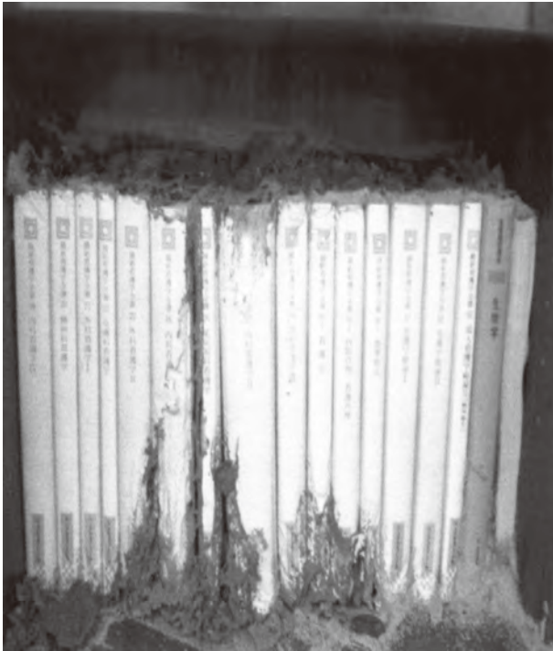
写真7 イエシロアリ本棚の被害
