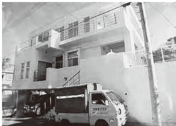
写真1 新築1年半の住宅(玄関インタフォンの被害)
