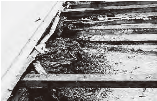
写真7 店舗床下のシロアリの被害
